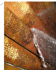
伝熱管からの給水の漏れ
